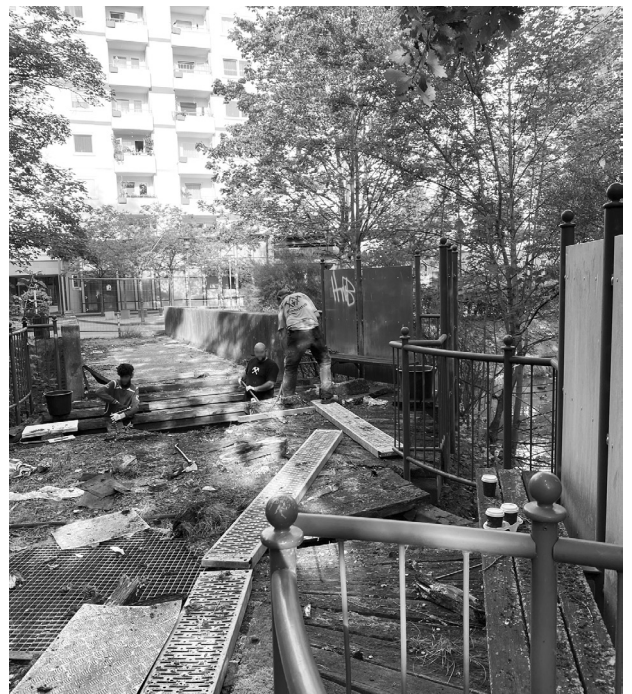
Kirchdorf-Süd ist überall von kleinen Gräben, Wattern genannt, durchzogen. Die hölzernen Fußgängerbrücken über die Wasserwege sind morsch. Hier, im Erlerring, wird nun mit der Sanierung begonnen. Foto: ein
