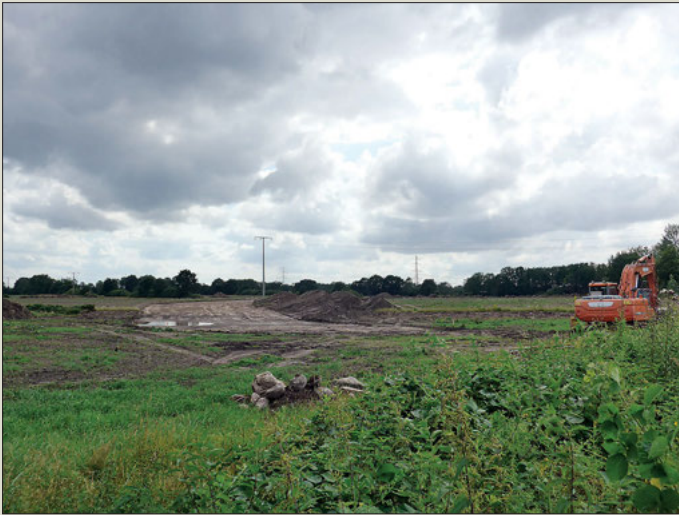
Letztes Jahr im Juli hatten bereits erste vorbereitende Baumaßnahmen für das geplante Gewerbegebiet Victoria Park begonnen.
