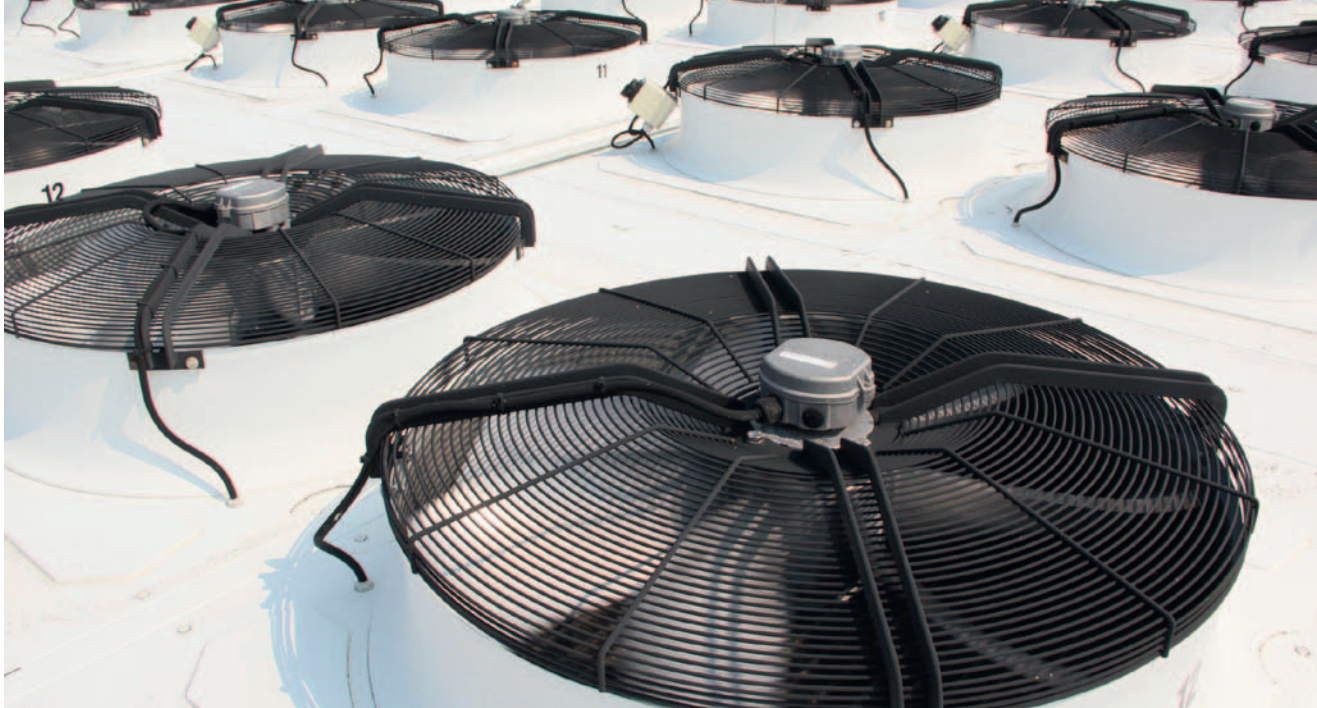
Auf dem Dach des DKRZ sind Ventilatoren installiert. Sie geben die vom Rechner produzierte Wärme ins Freie ab.
