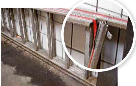
Defekte und beschädigte Leitern sind entweder fachgerecht instand zu setzen oder der Verwendung zu entziehen
