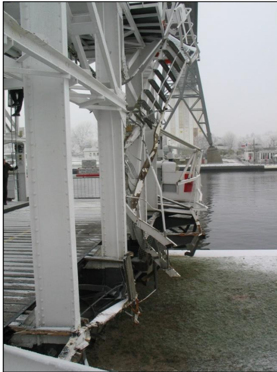
Abbildung 41: Blick auf die zerstörte Passagierplattform und den Zugang zum Fahrstand
