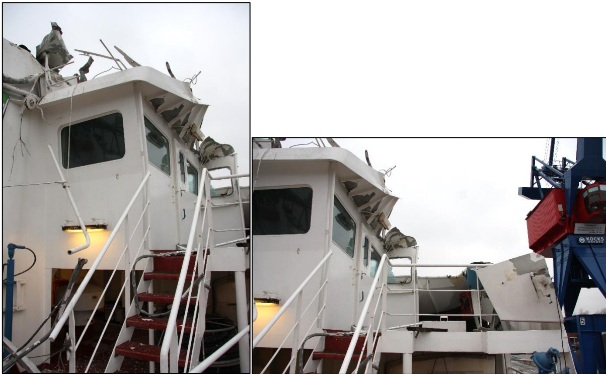
Abbildung 28: Beschädigte Backbord-Nock der EVERT PRAHM
