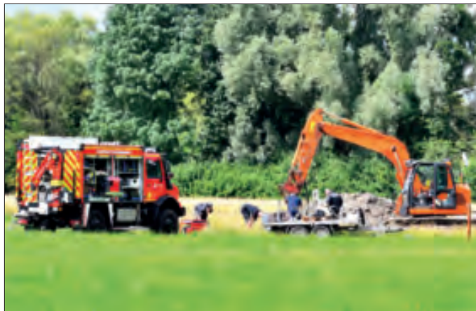
04.08.2020, KMFE, SCHNELSEN: Bei Bauarbeiten wird eine 1.000 lbs Fliegerbombe mit Aufschlagzünder 30 englischer Bauart gefunden, Feuerwehr richtet 300 Meter Sperrradius und 600 Meter Warnradius ein. Sprengladung wurde durch Kampfmittelräumdienst vor Ort erfolgreich gesprengt
