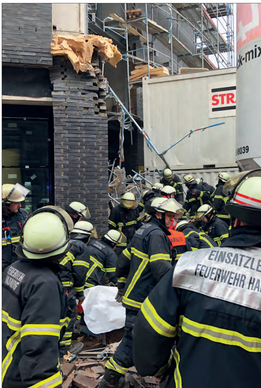
Trümmerfeld: Gefährlicher Einsatz nach dem Einsturz eines Baugerüsts in der Simon-von-Utrecht-Straße_Seite 22
