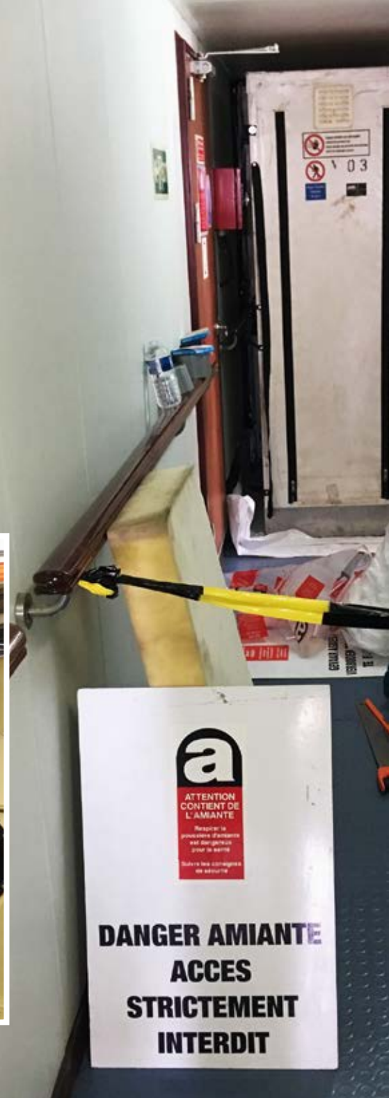
Am häufigsten sind Asbestfunde in Dichtungen.
