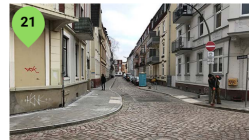
Aufwertung der Brookstraße Die Maßnahmen zur Umgestaltung der Brookstraße wurden im ersten Quartal 2020 abgeschlossen. Nach Erneuerung der Hausanschlüsse durch die Gasversorger wurden im Rahmen der Umgestaltungsmaßnahmen die Parkplätze auf die südliche Straßenseite verlagert und der Straßenverlauf verschwenkt.
