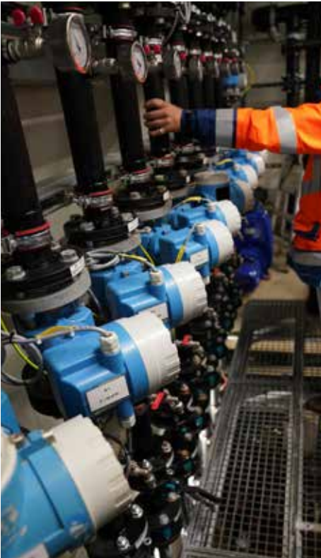
Erläuterung der Pumpenanlage (Foto:DerBi)
