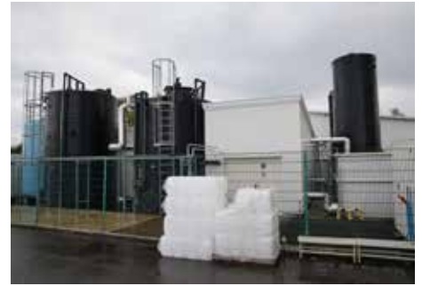
Teilansicht der aufwendigen Wasserbehandlungsanlage (Foto:DerBi)
