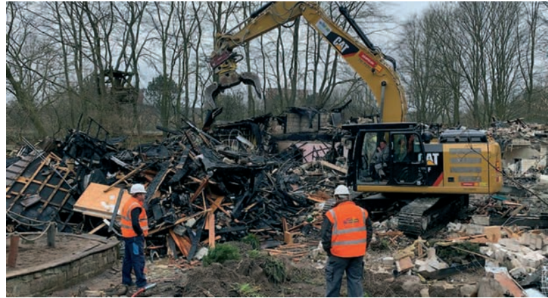
.... nur noch ein Trümmerhaufen
