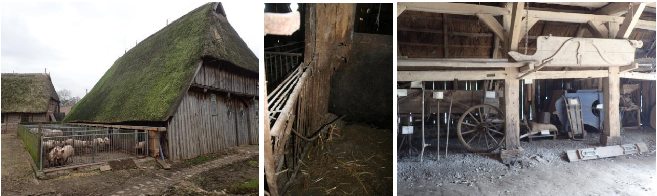
Scheune vor der Sicherung, Schadensbild Innenraum, Innenraum nach Abschluss der Arbeiten; Fotos: Hof Eggers
