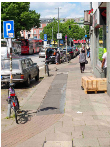
Unzumutbar: Parkpätze, Radweg, Fußweg auf engstem Raum und in schlechtem Zustand in der belebten Max-Brauer-Allee auf Höhe des Bahnhofs Altona.
