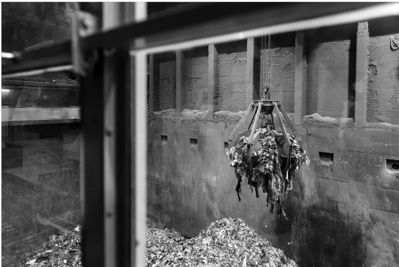
Abb.: Müllverbrennungsanlage. Foto: (c) H. Hass, Stadtreinigung Hamburg
