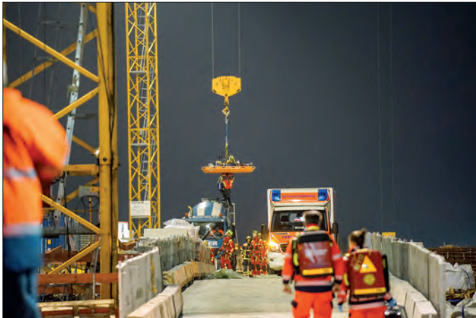
21.01.2020, THYHOE, Hafencity: Absturz eines Bauarbeiters in das Untergeschoss einer Baustelle. Rettung der Person mittels Schleifkorbtrage und Vakuummatratze mit Unterstützung der SEG Höhenrettung über einen Kran der Baustelle. Notarztbegleitete Beförderung des Verletzten ins Krankenhaus
