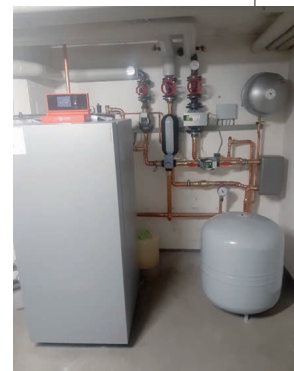
Neu eingebaute Heizungsanlage von Viessmann
