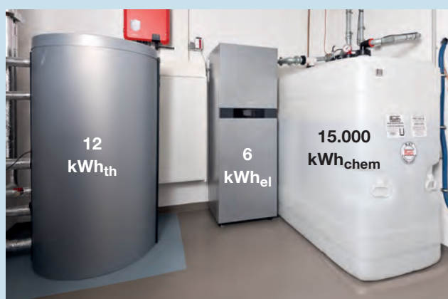
Drei Energiespeicher für Wärme, Strom und treibhausgasreduziertes Heizöl sind wichtige Bausteine der Strom- und Wärmeversorgung im Innovationshaus Wolfhagen.
