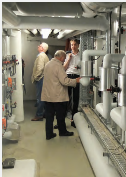
Im ETV-Haupthaus nahmen die Teilnehmer der Haushaltsrundfahrt die neue Heizungsanlage in Augenschein.
