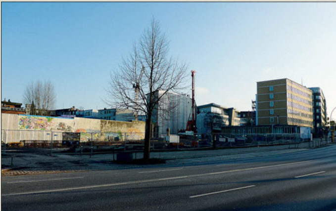
Wo in der Wandsbeker Allee 55 vormals das Bürgerhaus und ein Verwaltungsgebäude standen, baut seit Herbst 2017 die JOHANN BUNTE Bauunternehmung für die Baugenossenschaft Dennerstraße-Selbsthilfe eG (BDS).
