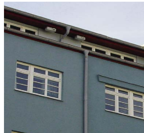
ungünstig: Mauerseglerkästen am Staffelgeschoß- hier fehlt der freie Anflug
