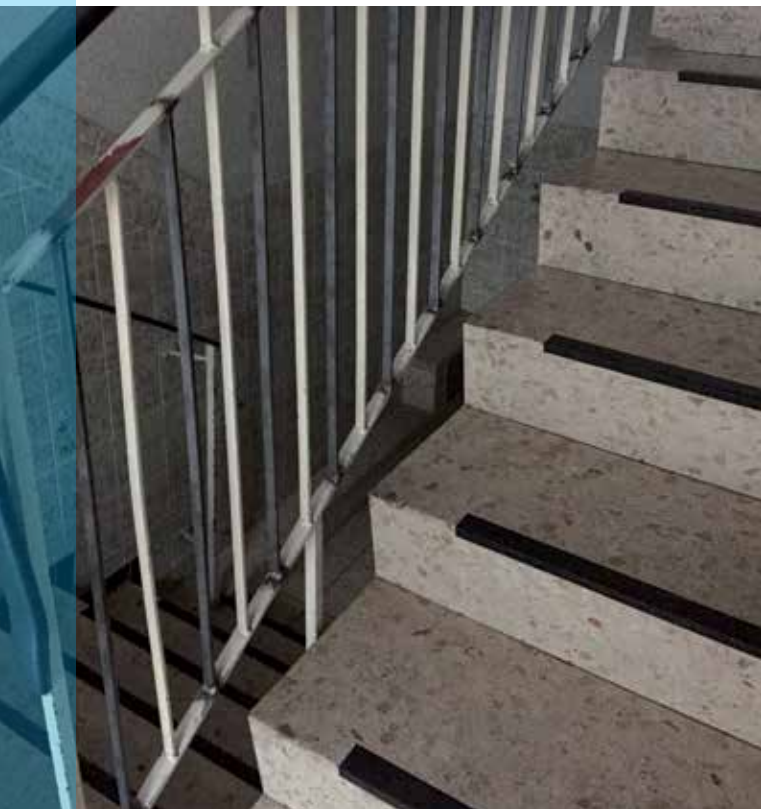
Verkehrssicherungspflichten – Nachrüstung beim Treppenhausgeländer
