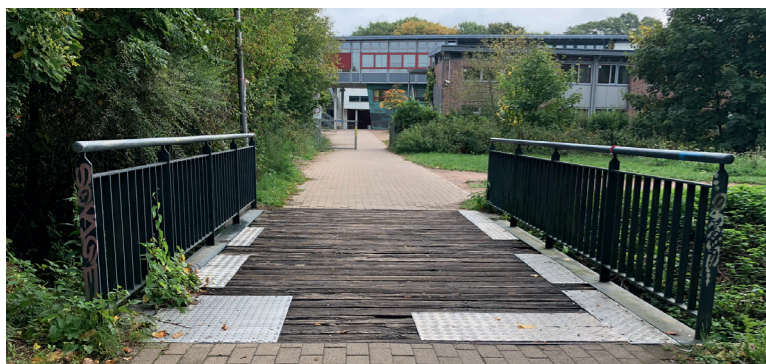
Fußgängerbrücke an den Walddörfer Schulen: Vorher ein ähnliches Bild, inzwischen wurde der Bohlenbelag...
