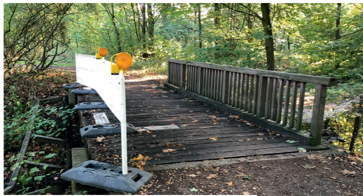
Brücke am Allhorndiek: Das Gelände ist abgefault, eine Absperrung sorgt für Sicherheit.
