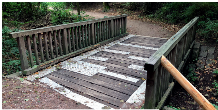
Brücke hinter dem Museumsdorf: Die Bohlen sind geflickt, das Gelände wird mit Pfosten gestützt.
