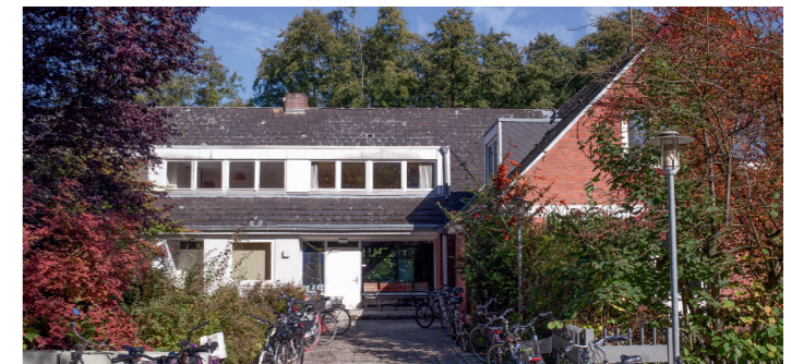
Das alte Gemeindehaus mit Pfarrei ist in keinem guten Zustand. Abriss und Neubebauung wären sinnvoll.
