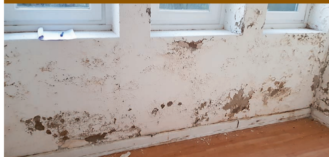
Bei feuchten Wänden: Schnell handeln!
