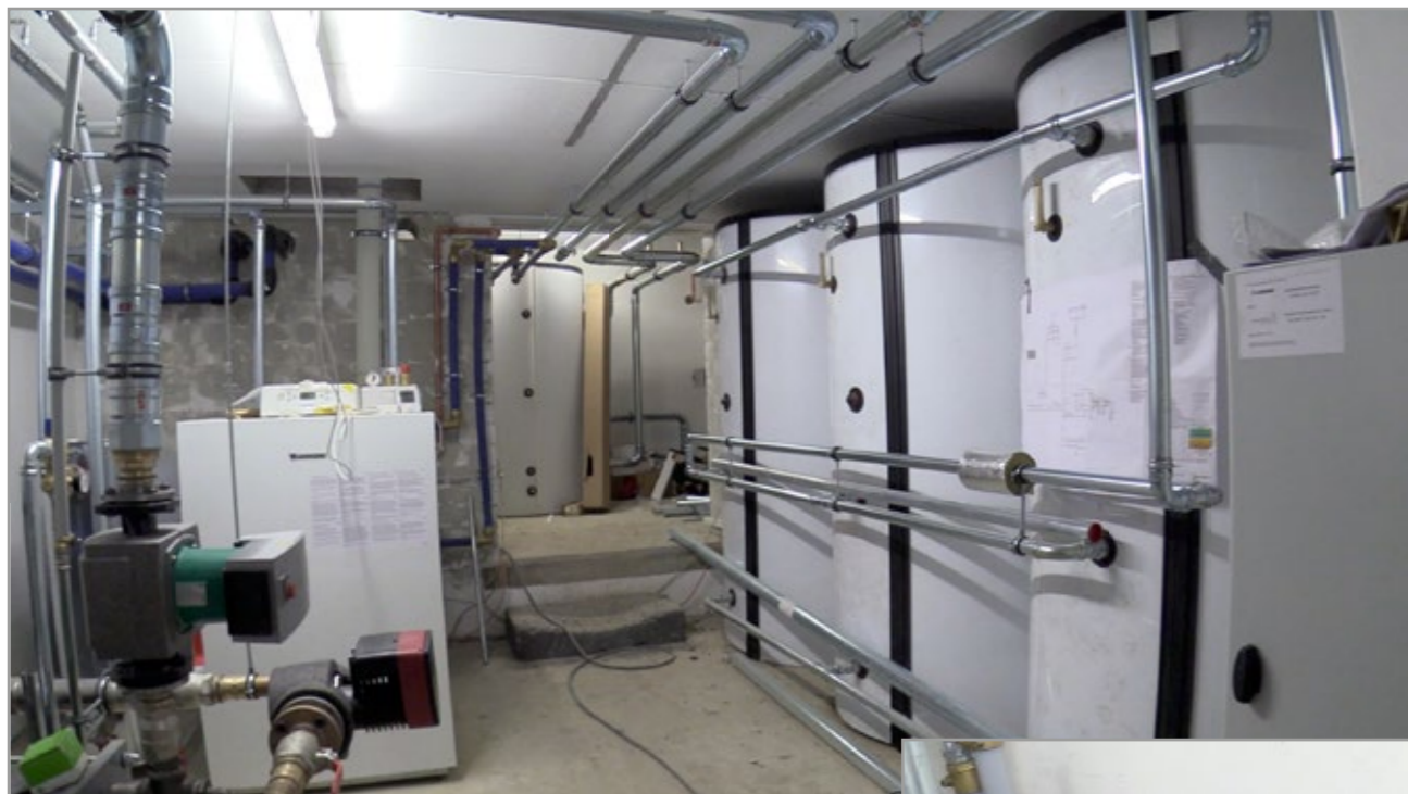
In der Heizungszentrale sind bereits alle wichtigen Komponenten (Speicher, Wärmepumpe, Brennwertgerät usw.) vorhanden. Die Isolierungen fehlen noch, die Elektronik wird installiert.
