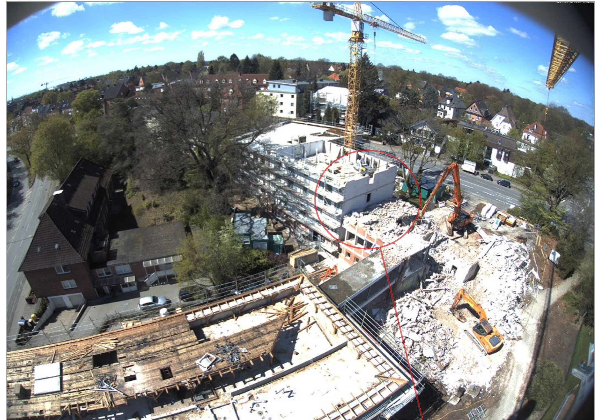
Vor dem Abbruch neu errichtete Giebelwand als neue Außenwand von Haus 46 c.
