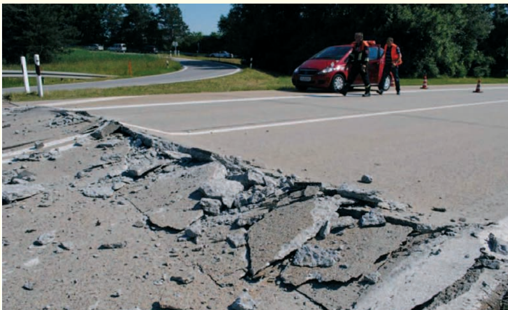
blow ups auf der Autobahn
