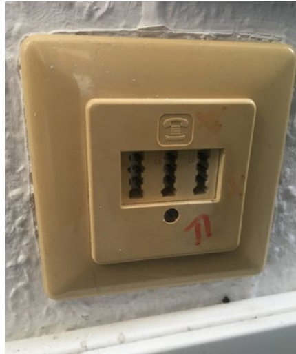
Defekte Anschlüsse muss der Vermieter reparieren
