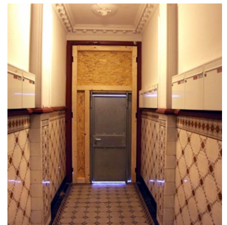
Jugendstilfliesen an den Wänden und statt der hölzernen Eingangstür eine provisorische Baustellenpforte aus Stahl
