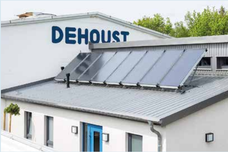
Auf dem neuen Sozialgebäude ist eine Solarthermieanlage mit insgesamt acht Flachkollektoren installiert. Heizung und Warmwasser des Neubaus werden hauptsächlich solar bereitgestellt.
