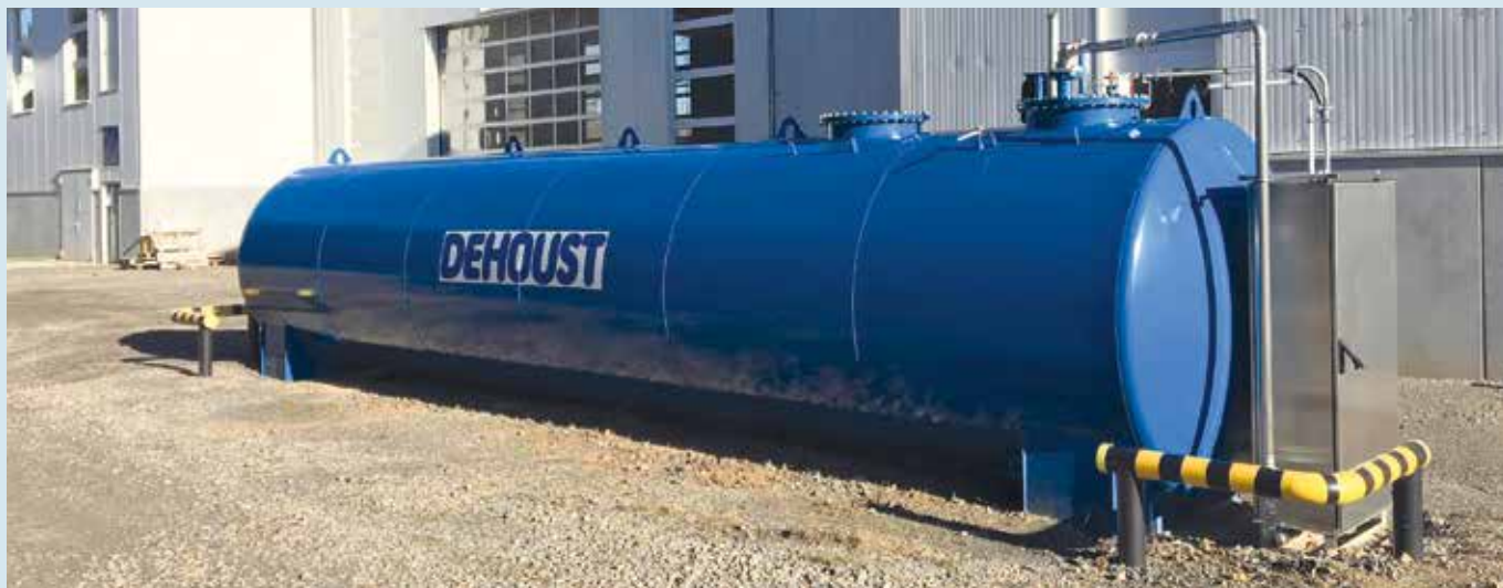
30.000 Liter Heizöl fasst der doppelwandige Stahlzylindertank mit automatischer Lecküberwachung und Tankheizung. Er stellt die Brennstoffversorgung der Brennwertkessel in der Lackierhalle sicher.
