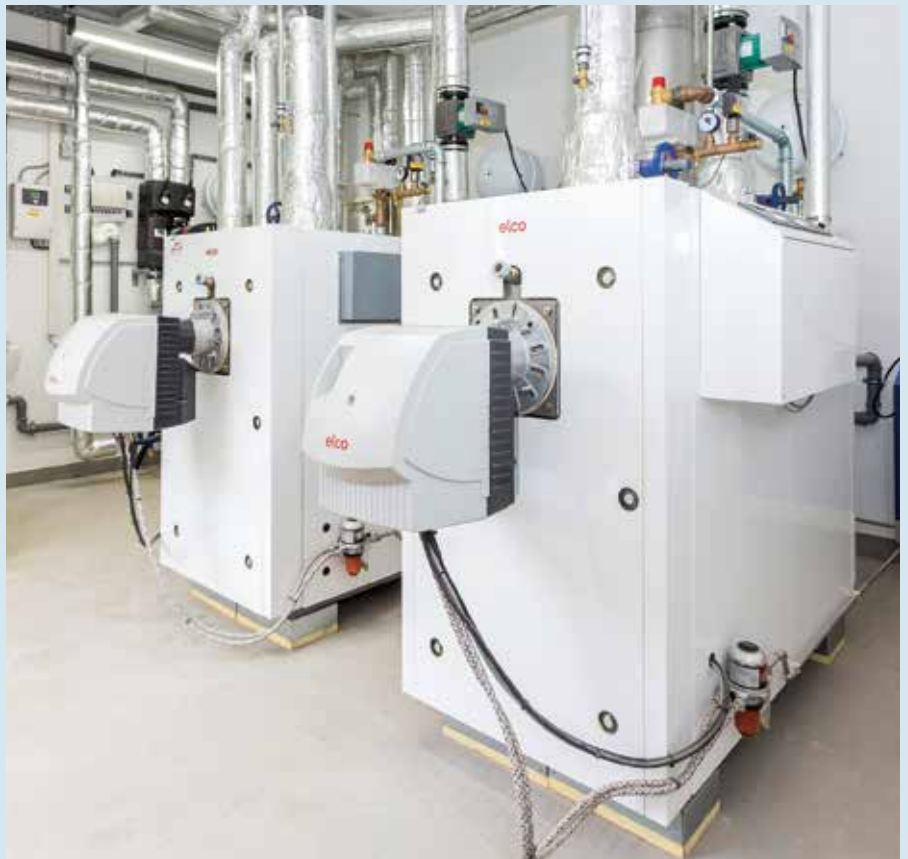
In der Lackierhalle sind zwei 150-kW-Öl-Brennwertkessel installiert. Sie ergänzen die Luft-Wasser-Wärmepumpe. Das neue Heizsystem soll künftig auch die bestehende Produktionshalle mit Wärme versorgen.
