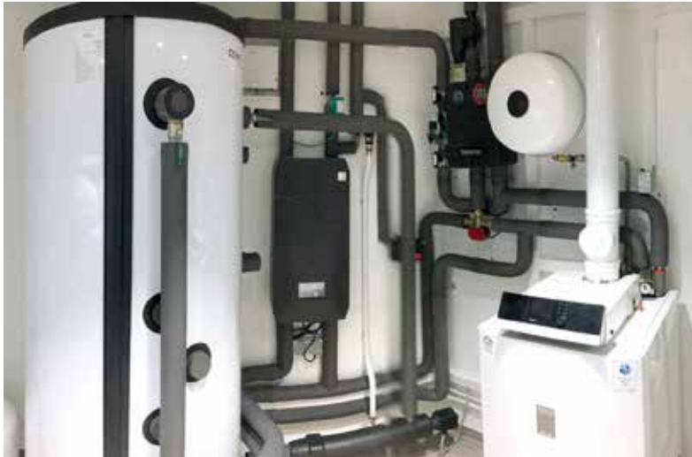
Eine von insgesamt 13 Öl-Hybridheizungen in der Modellregion Lübke-Koog. Die Einbindung von Windstrom zur Wärmeerzeugung erfolgt über einen elektrischen Heizstab, einen Elektroumlaufheizer oder eine Strom-Wärmepumpe.
