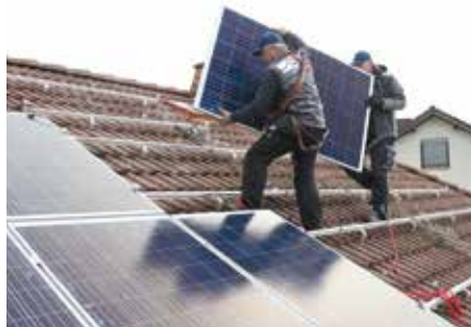
Auf Deutschlands Dächern ist noch viel Platz für Photovoltaikanlagen.
