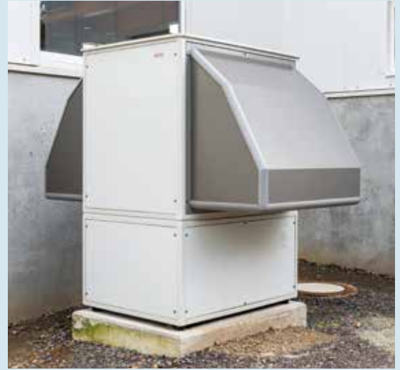
Für die neue Lackierhalle sowie für die Produktionshalle liefert eine Luft-Wasser-Wärmepumpe regenerative Energie, um die Anforderungen der EnEV zu erfüllen.
