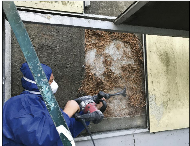
Unzulässig: Brennbares Dämmmaterial in der Fassade eines Hochhauses_Seite 08
