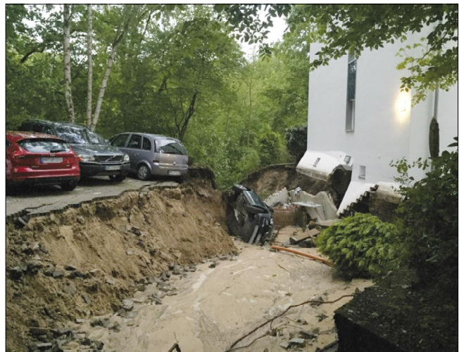
Starkregen: In Lohbrügge rissen die Wassermassen ganze Straßen samt Uferbefestigungen mit sich_Seite 16
