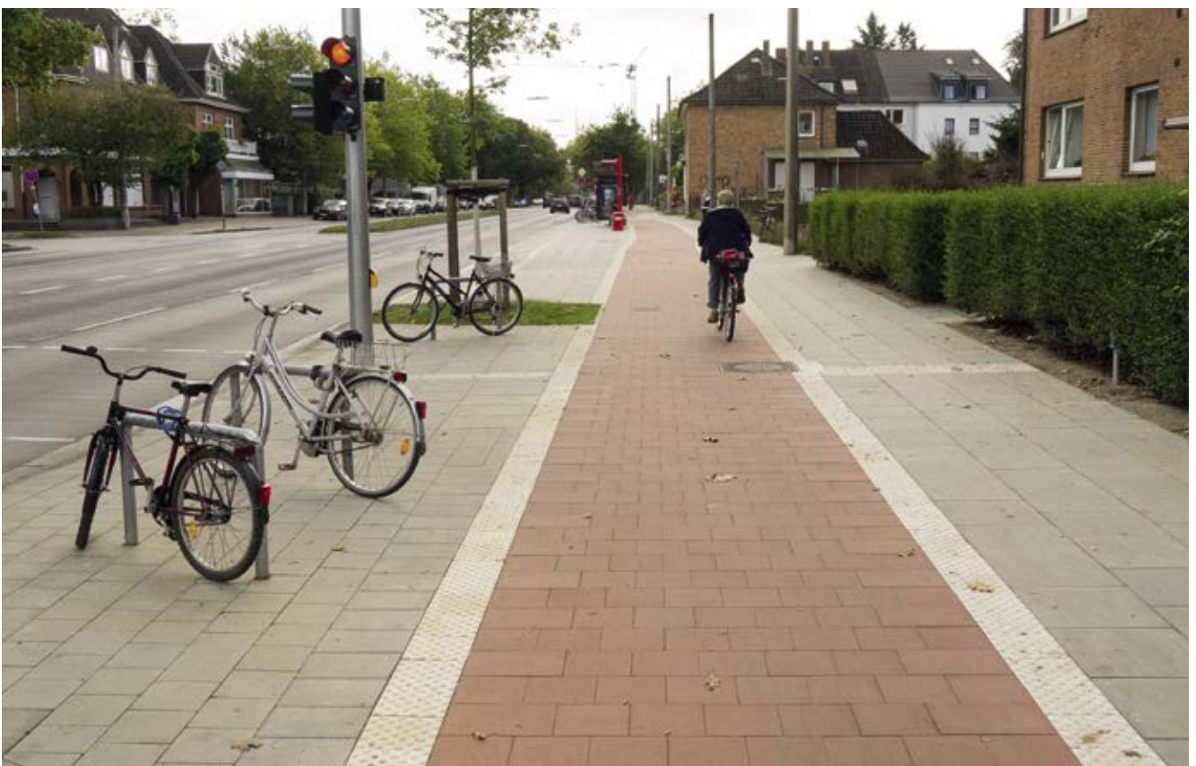
Bild 86: Lokstedter Steindamm, Ausbau und Verbreiterung des Radwegs sowie Aufstellung von Fahrradbügeln im Rahmen des Bushaltestellenausbaus
