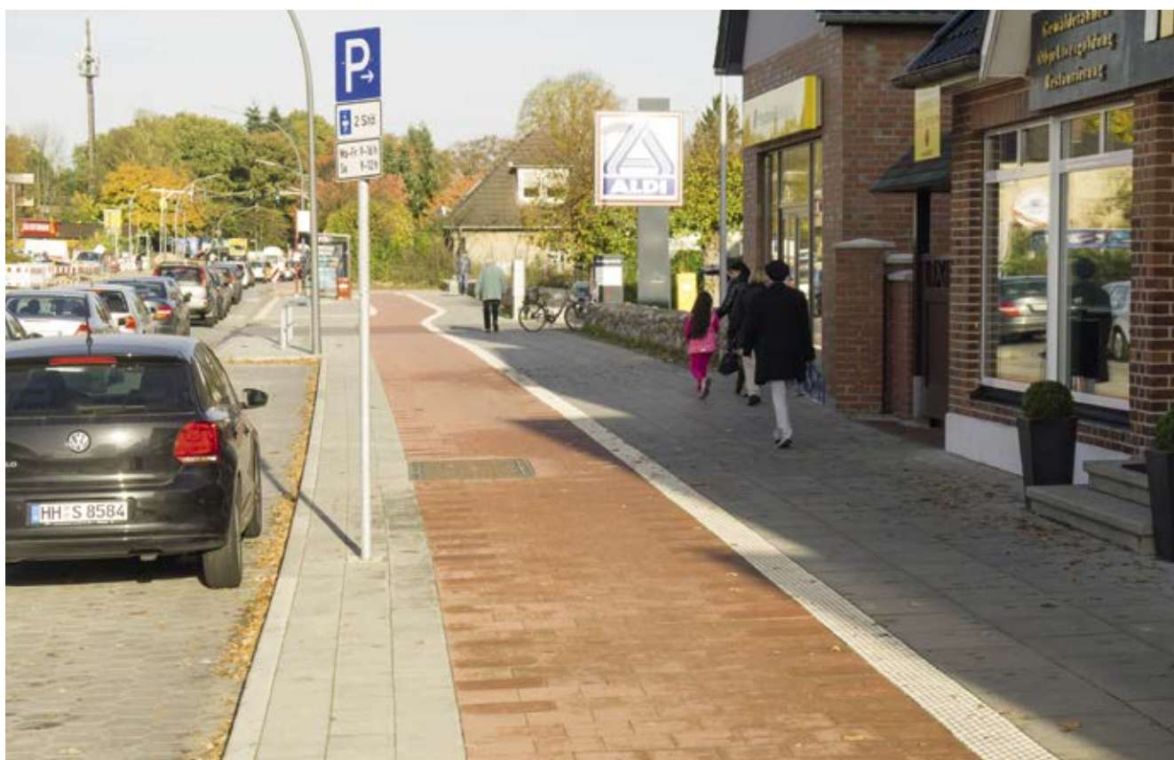
Bild 108: Meiendorfer Straße, Ausbau und Verbreiterung des Radwegs im Rahmen der Grundinstandsetzung der Straße
