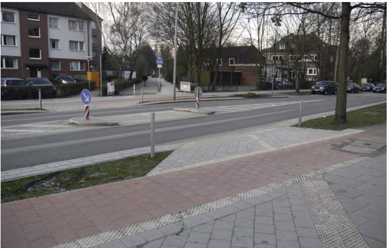
Bild 40: Georg-Wilhelm-Straße / Gert-Schwämmle-Weg (Veloroute 11, Freizeitrundkurs Wilhelmsburg), Querungshilfe, Einbau taktiler Leitelemente für Blinde und Sehbehinderte
