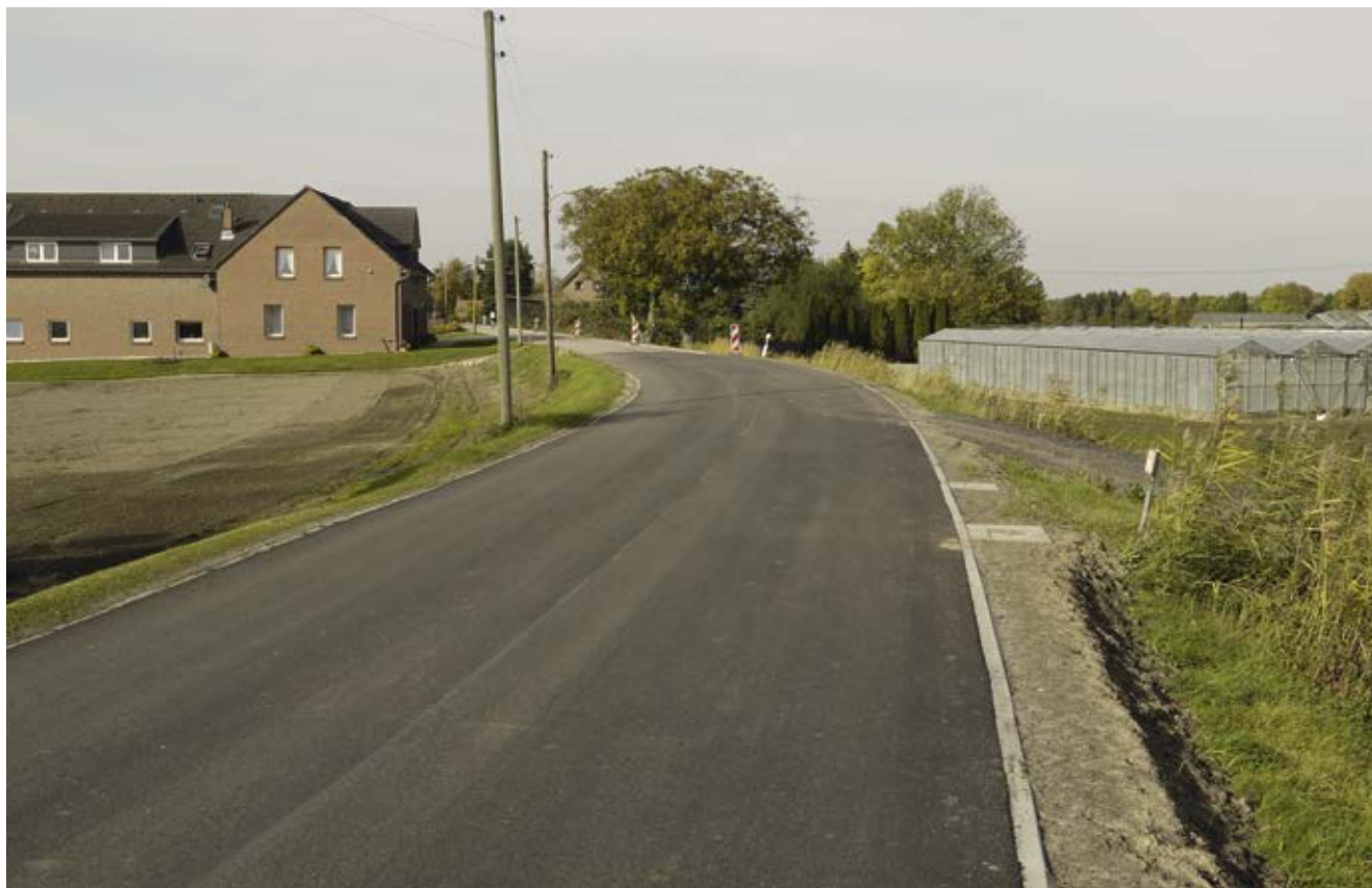
Bild 57: Ochsenwerder Norderdeich (Bestandteil des Freizeitnetzes in den Vier- und Marschlanden), Sanierung der Fahrbahndecke
