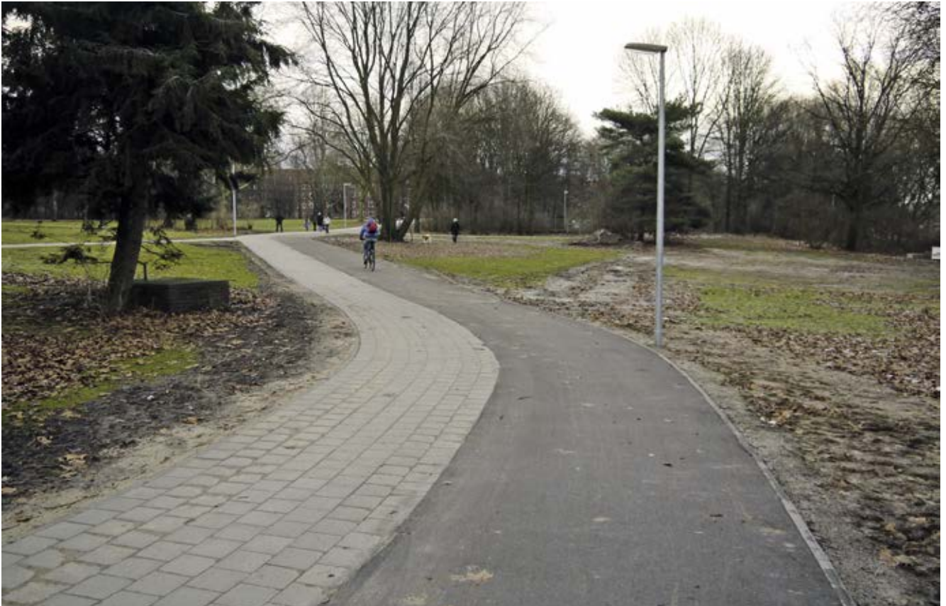
Bild 23: Thörls Park (Veloroute 8), Ausbau und Verbreiterung des getrennten Geh- und Radweges, Erneuerung der öffentlichen Beleuchtung (Zustand Januar 2013)
