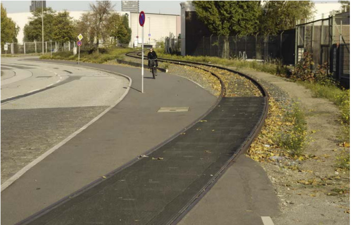
Bild 35: Reiherdamm (Veloroute 11, Freizeitroute 14, Hafenerlebnisroute), Hafengebiet, Bau eines gemeinsamen Geh- und Zweirichtungsradweges, Einbau von „Velostrail“ in Gleisquerungen zur Vermeidung von Stürzen
