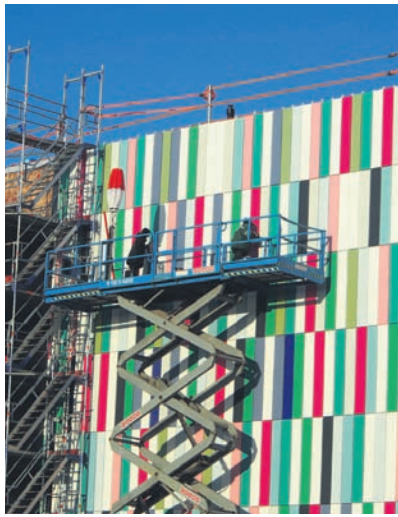
Hier wird Hand an die Fassade gelegt. Sie besteht aus 14 850 vertikalen farbigen Paneelen mit einer Gesamtfläche von 8500 Quadratmetern. Allein die Unterkonstruktion hat eine Länge von 27 Kilometern, das entspricht in etwa der Distanz zwischen Stelle und Buchholz.
