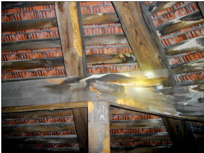
Ein geborstener Dachbalken.
