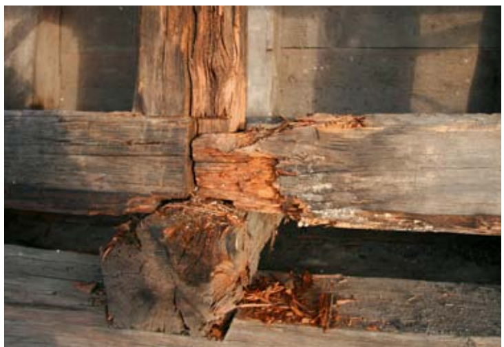
Schäden an den Dachbalken
