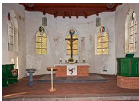
Blick in den Chor mit abgeplattem Wandputz vor der Restaurierung
