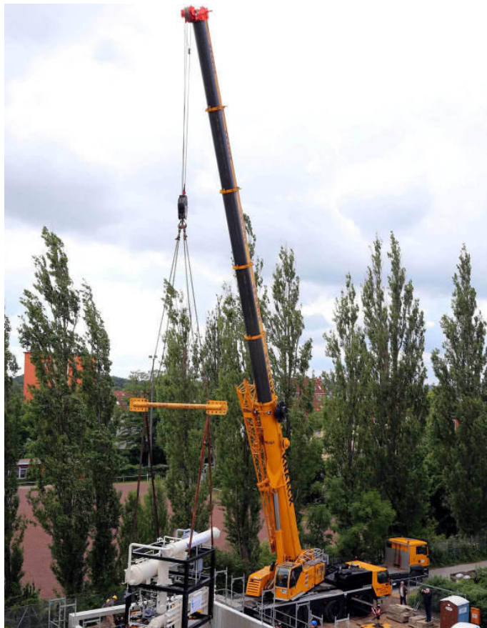
Anlieferung der Gasabsorptionswärmepumpe (Foto EBV)
