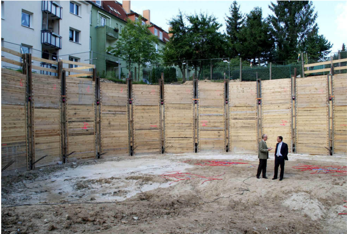
Die Baugrube des Eisspeichers entsteht. Im Bild: GdW-Präsident Axel Gedaschko mit EBV-Vorstand Joachim Bode während der Bauphase (Foto EBV)
