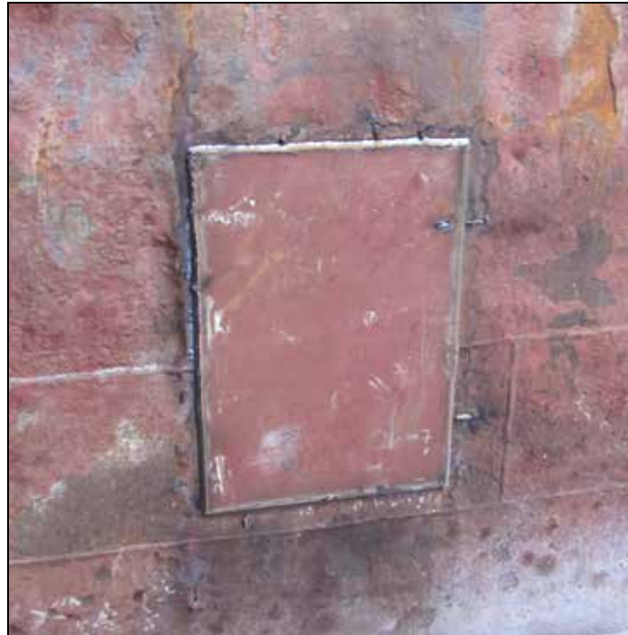
Abbildung 44: Abdichtung eines Mannlochdeckels mittels darüber geschweißter Stahlplatte
