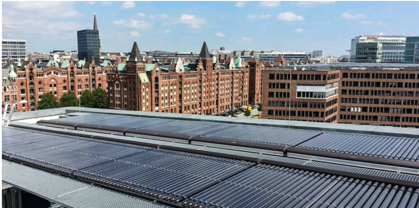
Solarwärme-Anlage auf einem Firmengebäude in der HafenCity, installiert von einem Hamburger Fachbetrieb.
