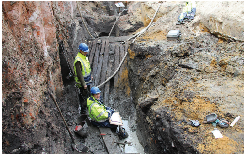
Schräge Holzlage und steigendes Grundwasser. Foto: © AMH
