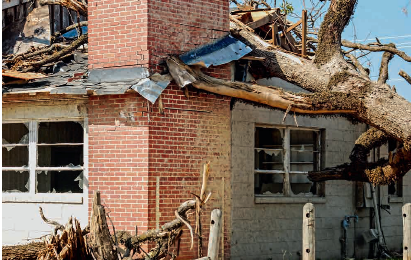
Vom Sturm zerstörtes Haus.
