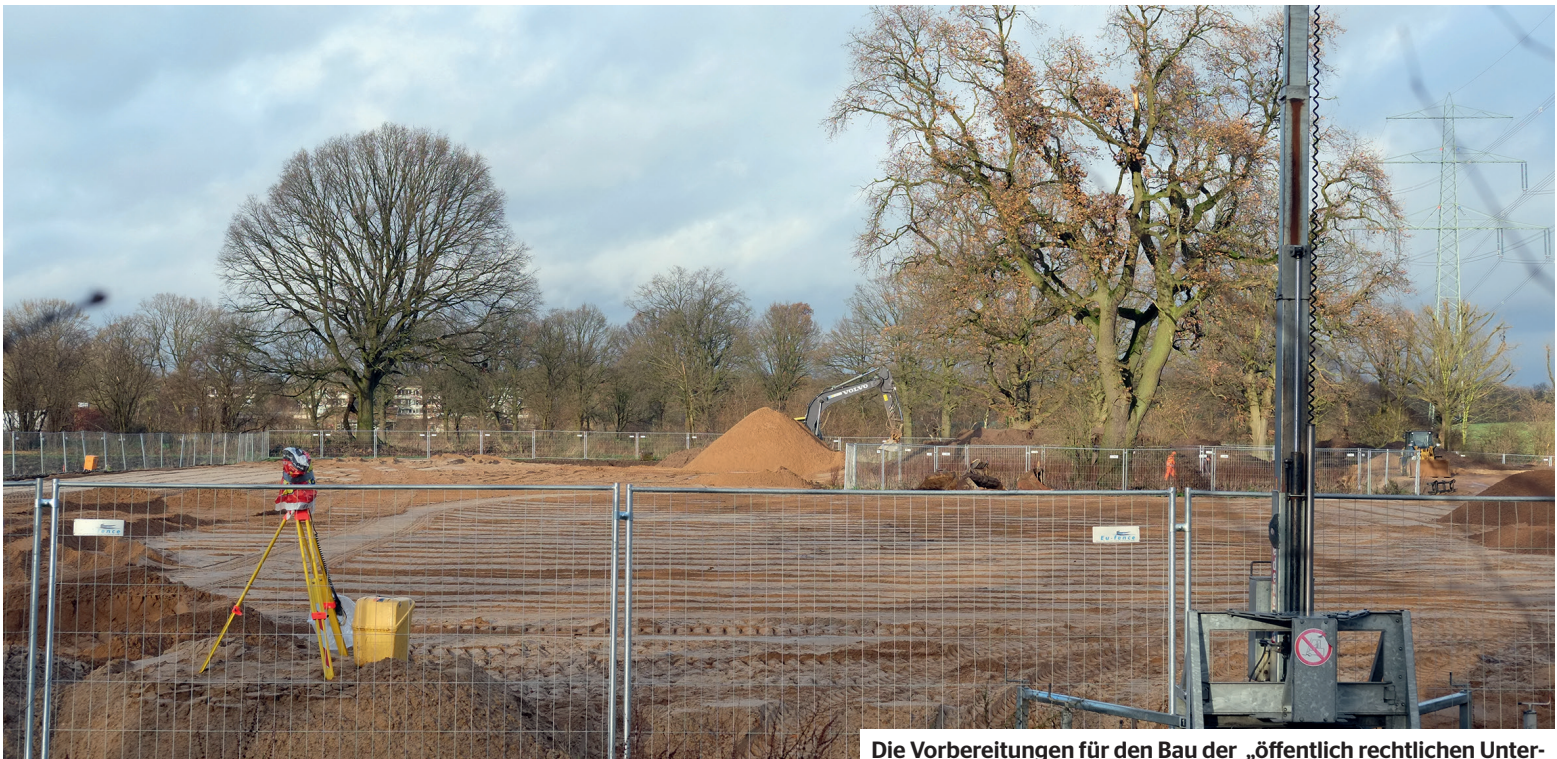
Die Vorbereitungen für den Bau der „öffentlich rechtlichen Unterbringungen“ (ÖRU) - für Flüchtlinge - sind bereits im vollen Gange.
