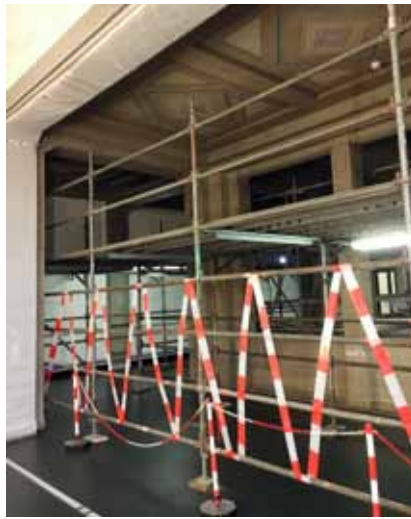
Sicherung im 2. Obergeschoss
