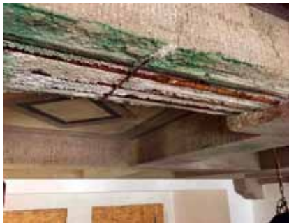
Schaden an der Schmuckdecke
