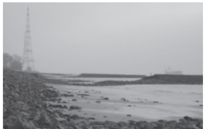
Abb. 4 Bühnenschäden seit 2001. Durchbruch des Landanschlusses bei Juelssand © Uliczka, BAW
