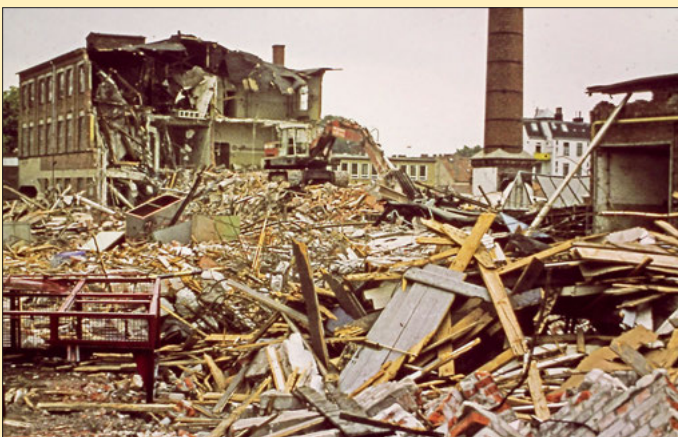
Die verschiedenen Häuser auf dem Firmengelände sind zerstört. Der Schutt liegt zur Abholung bereit.
