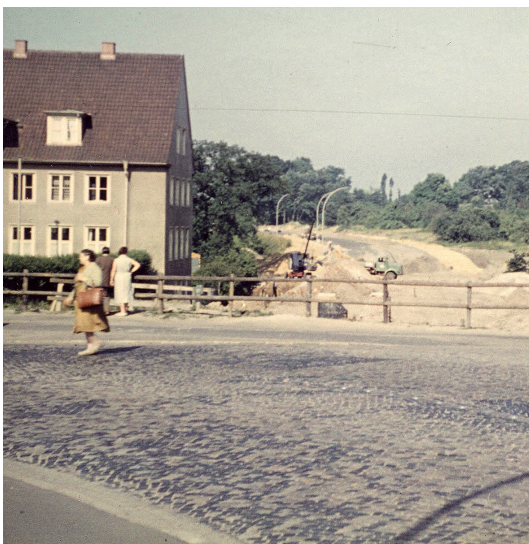
Damals wie heute - ein Loch: Krohnstieg 1961, Ausbau des Rings 3. Das Haus von Jonas steht noch, links das Postgebäude, das im August 2006 abgebrochen wurde.
