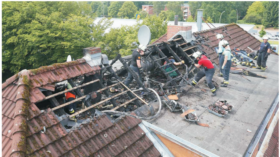
Ein Kugelblitz hat in das Wohngebäude an der Langenhorner Chaussee eingeschlagen.
