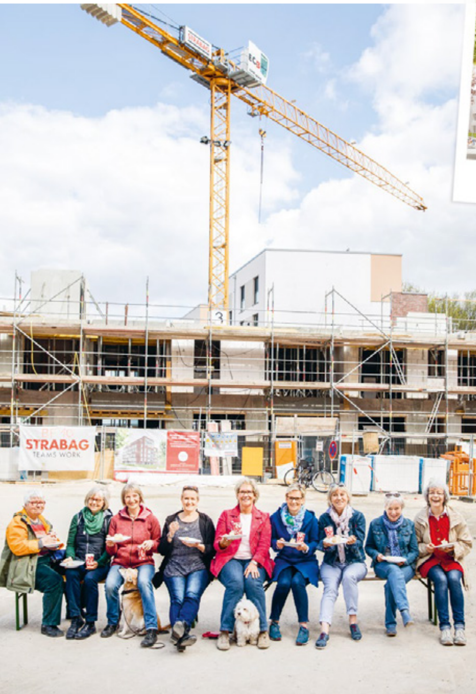
Mitglieder des Wohnprojekts Arche Nora auf der Baustelle Finkenau: Karin, Dorothea, Birgit, Maren, Kirsten, Uta, Ulla, Ingrid, Anna (von links)
