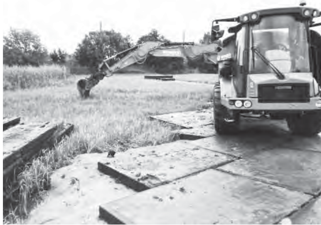
Der erste „Spatenstich“ für den zweiten Priel im Deichvorland an der Norderelbe in Georgswerder. Foto: MG
