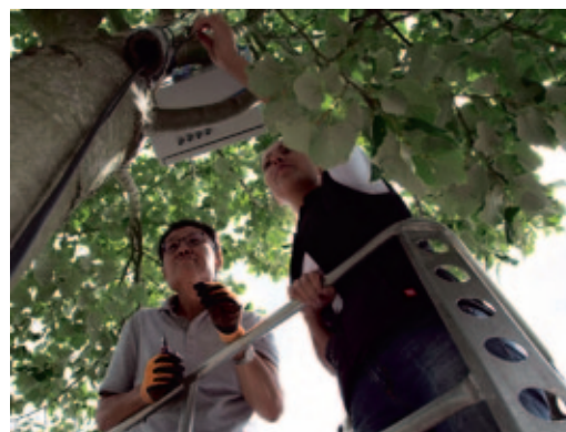
Fingerspitzengefühl gefragt: Dr. Jinchun Liu und eine Mitarbeiterin, Firma Ecomatik Dachau, beim Verkabeln der einzelnen Sensoren im Herzstück der Messanlage. Die Langzeitdaten werden minütlich erfasst und direkt am Baum gespeichert. (Fotos: Bayerische Landesanstalt für Weinbau und Gartenbau, Veitshöchheim)
