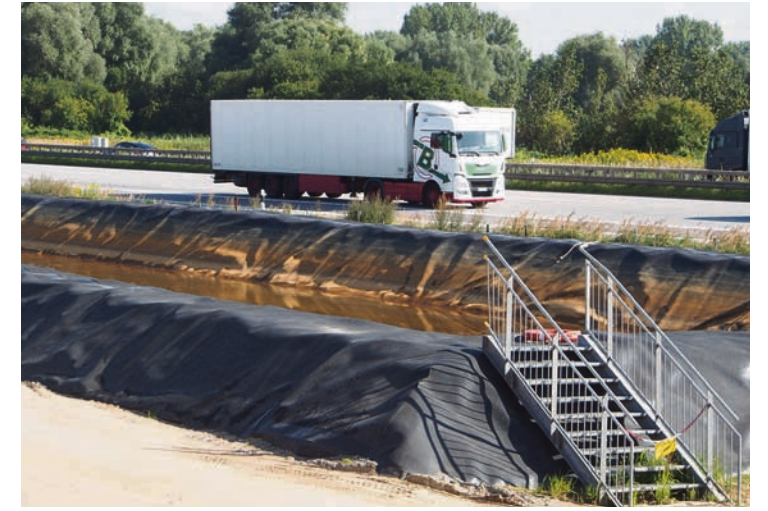
Entlang der A7 sind zwei Auffangbecken für das Wasser aus dem Torf angelegt worden. Eines dient zur Klärung, das andere als Pufferspeicher (Foto). Das saubere Wasser wird dosiert in die Neuländer Wettern geleitet und landet schließlich in der Elbe.
