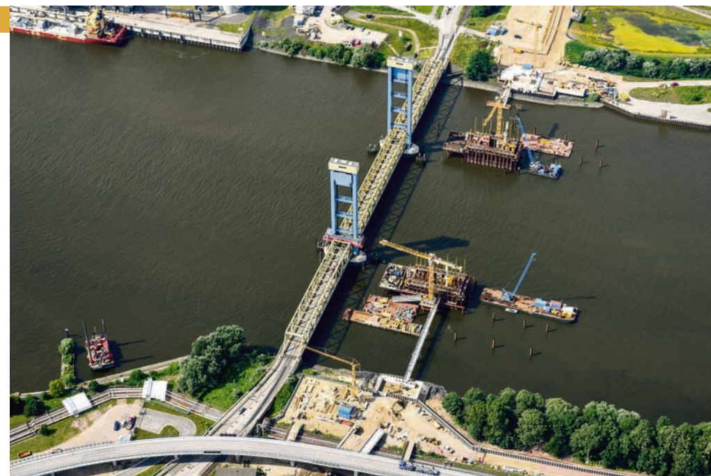
Aus der Luft: So sind die beiden Baugruben für die Stropfweiler in der Süderelbe positioniert. Sie stehen 108 Meter weit auseinander.
