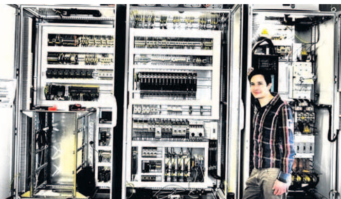
Ein Fall für Spezialisten: Oliver Horn vor dem mehr als zwei Meter hohen Schaltschrank des Danfoss-Hydraulik-Prüfstands. Seine Aufgabe sind der Einbau und die Verkabelung der Bauelemente. Auch die Lüfter und die Kühlanlagen gehören zur elektrotechnischen Ausstattung. Fotos: Wolfgang Becker
