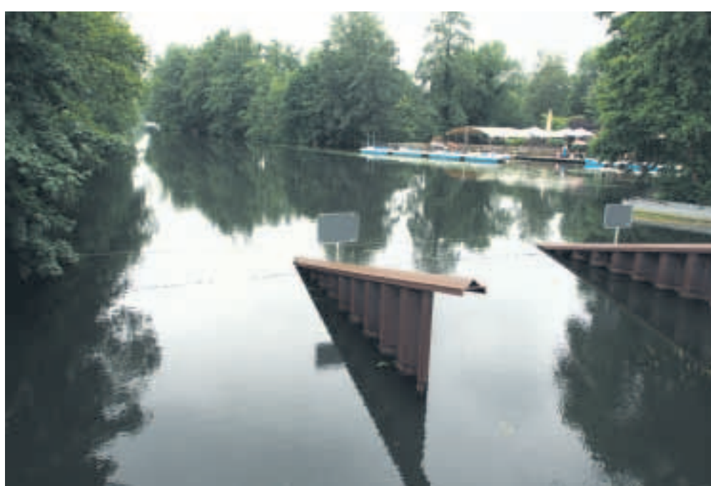
Das Ilmenau-Wehr, über das auch eine Fußgängerbrücke Richtung Altstadt führt, liegt etwa auf halber Höhe des langgestreckten Baufeldes. Hier ist auch der Bootsverleih stationiert.
